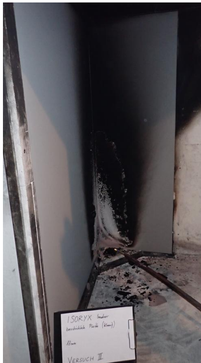
Bild 11: Prüfkörper nach der Prüfung, Nahaufnahme der Außenkante
